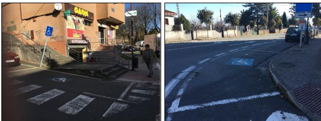
Figura 42: Prazas de PMR con problemas. Mal estado pintura (esq.) e falta señal vertical (der.)
