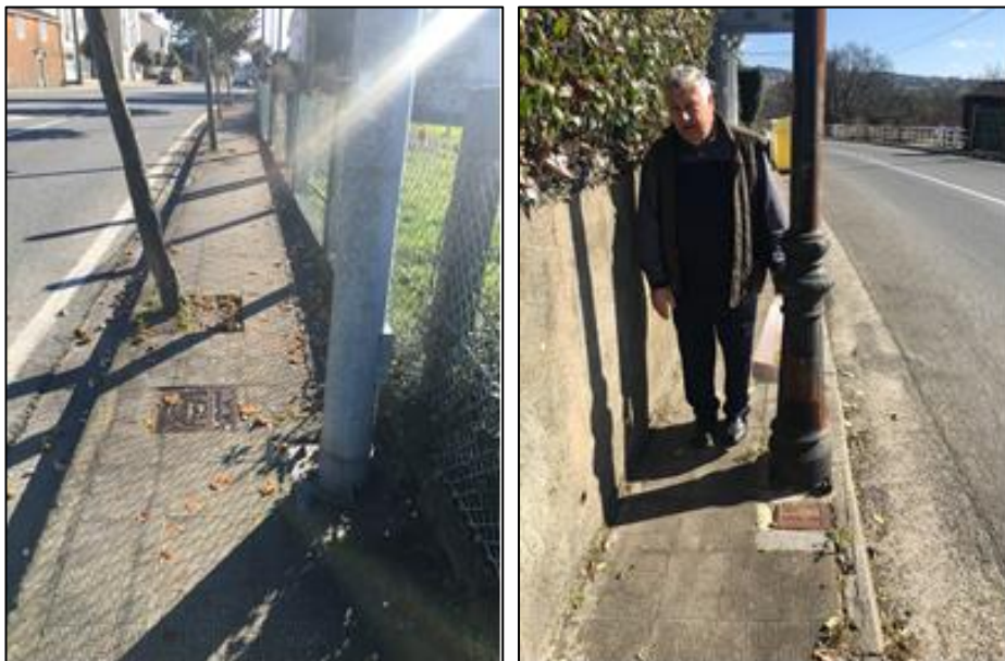
Figura 25: Sección insuficiente en beirarrúas. Ocupación por árbores (esq.) e luminarias (der.)
