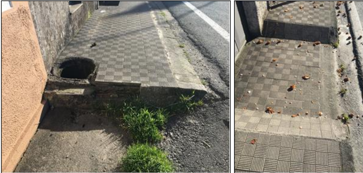
Figura 24: Falta de seguridade nas beirarrúas. Ausencia de tapa (esq.) e forte desnivel (der.)
